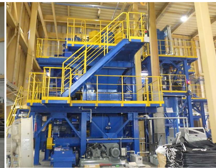
セメント固型化設備
