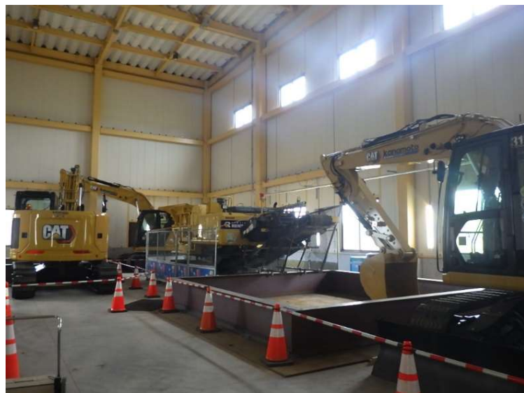
不燃物詰替設備①
