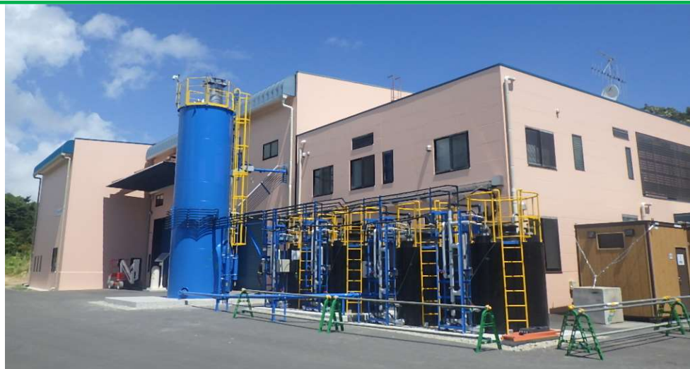
左手側から不燃物詰替施設、セメント固型化施設、管理棟
