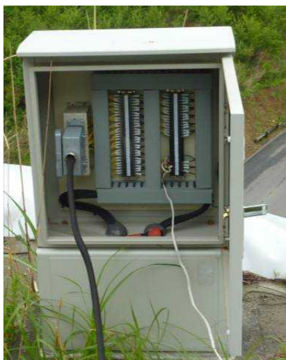
図3 端子盤結線状況
