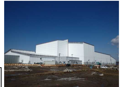
富岡町における仮設焼却施設(平成27年3月)
