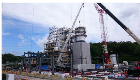
楢葉町の仮設焼却施設 (平成28年6月)
