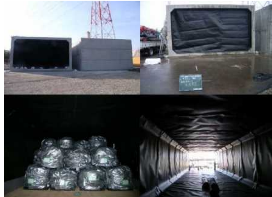
焼却灰をフレキシブルコンテナに詰めボックスカルバート内に保管
