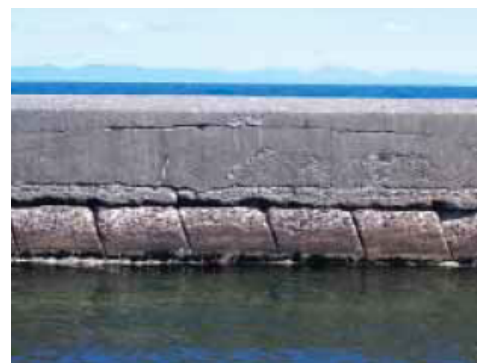
100年以上前に構築されたコンクリートブロック（海面近くの黒い部分）
