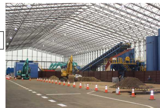
受入・分別施設(大熊1期②工区)
