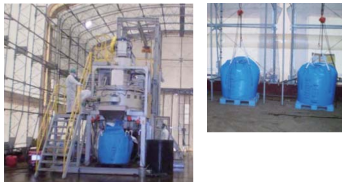
セメント固型化施設実証事業における実施例
