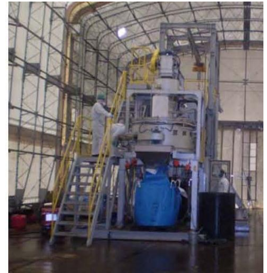
セメント固型化施設の例 (セメント固型化施設実証事業)
