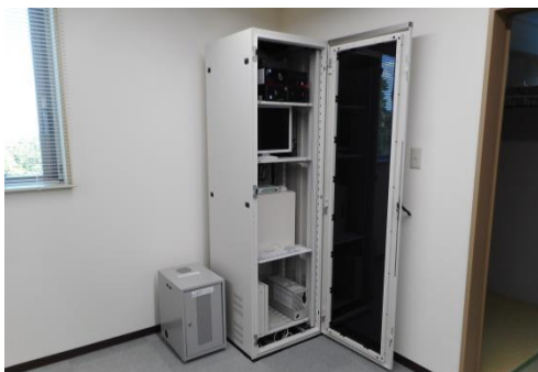
データ収集サーバ (管理棟に配置)
