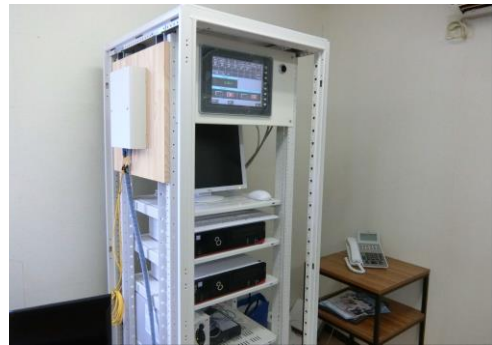
制御盤(業務棟に配置)
