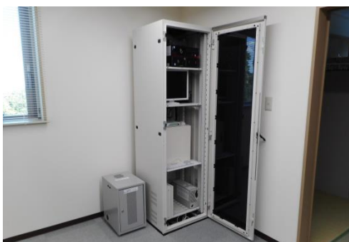
データ収集サーバ (管理棟に配置)
