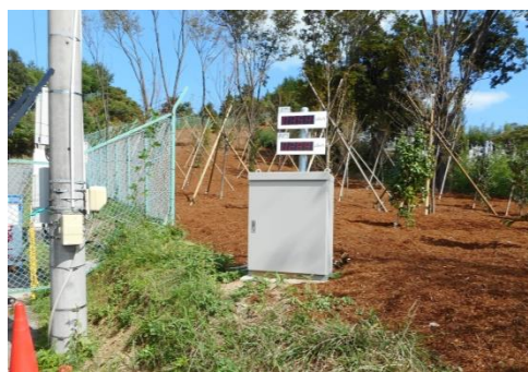
線量率表示機 (正門付近に設置)
