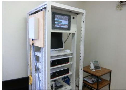
制御盤(業務棟に配置)
