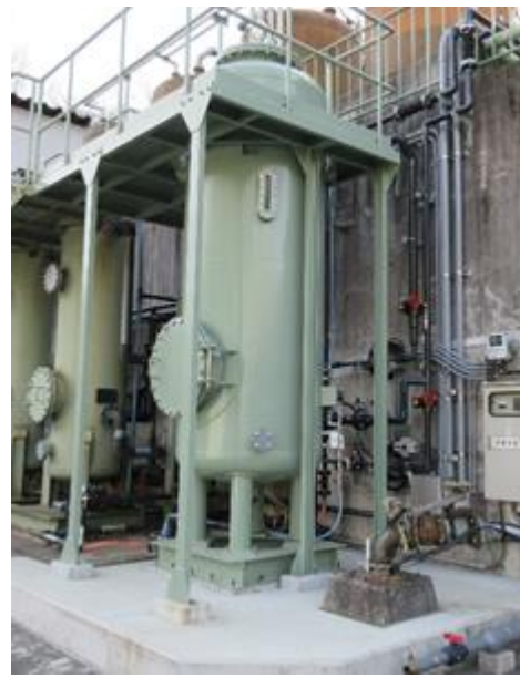
フッ素除去設備
