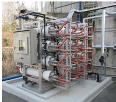
ホウ素除去設備
