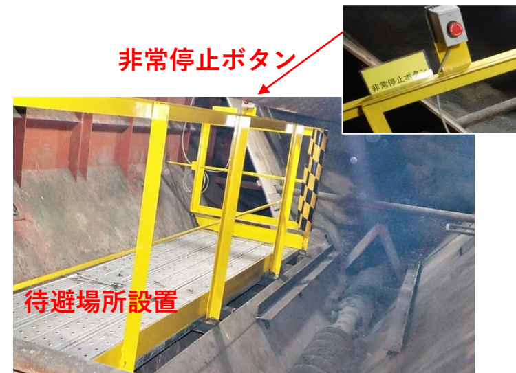
応急的対策の状況
