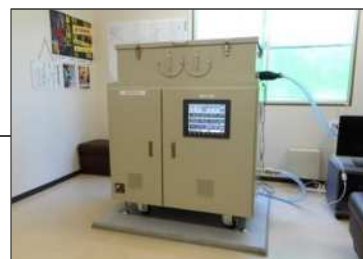
業務棟の測定装置
