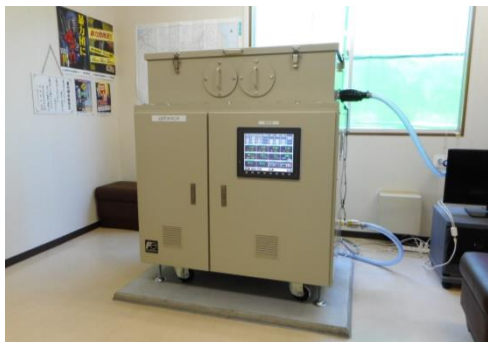
業務棟の測定装置
