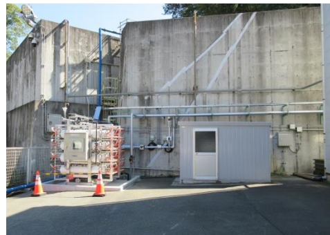
ユニットハウスの状況
