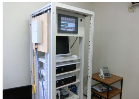
制御盤(業務棟に配置)
