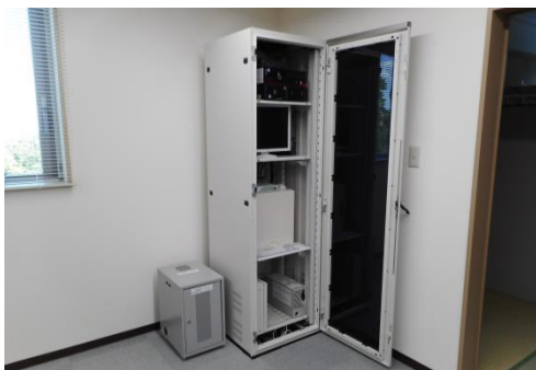
データ収集サーバ (管理棟に配置)
