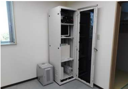
データ収集サーバ (管理棟に配置)
