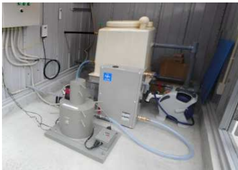
ユニットハウス内の測定装置
