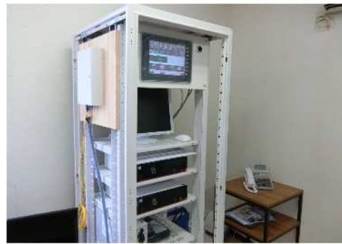
制御盤(業務棟に配置)
