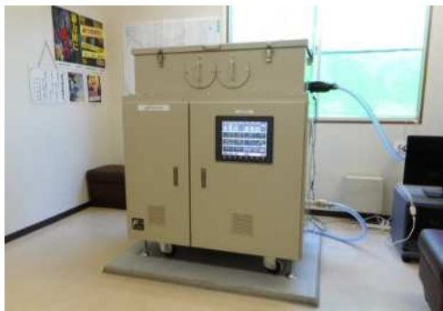
業務棟の測定装置
