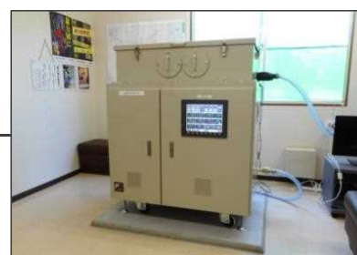
業務棟の測定装置
