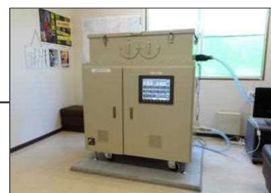
業務棟の測定装置
