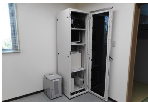
データ収集サーバ (管理棟に配置)
