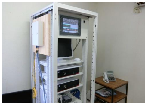
制御盤(業務棟に配置)
