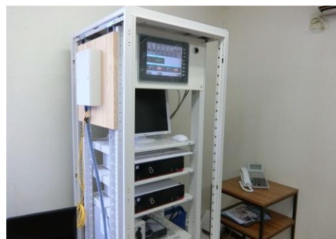
制御盤(業務棟に配置)
