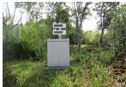
線量率表示機 (正門付近に設置)
