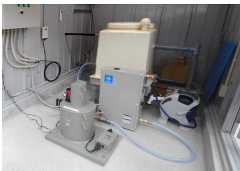
ユニットハウス内の測定装置
