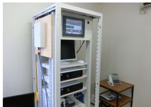
制御盤(業務棟に配置)
