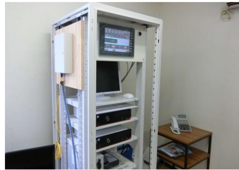
制御盤(業務棟に配置)
