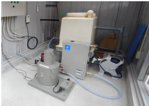
ユニットハウス内の測定装置
