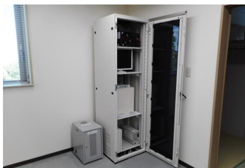
データ収集サーバ (管理棟に配置)
