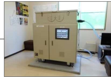
業務棟の測定装置
