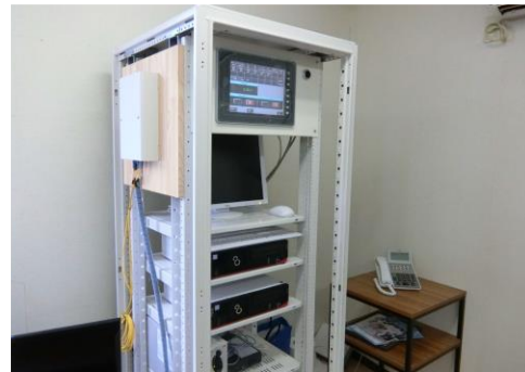
制御盤(業務棟に配置)
