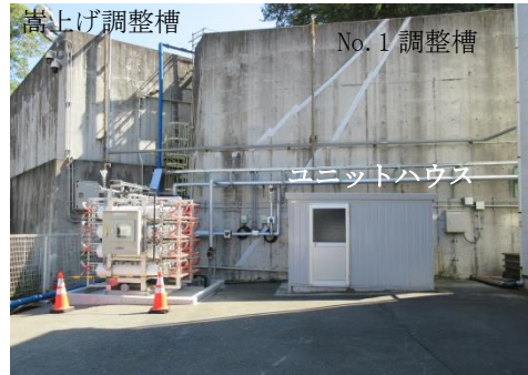
ユニットハウスの状況
