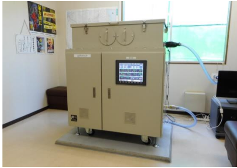
業務棟の測定装置
