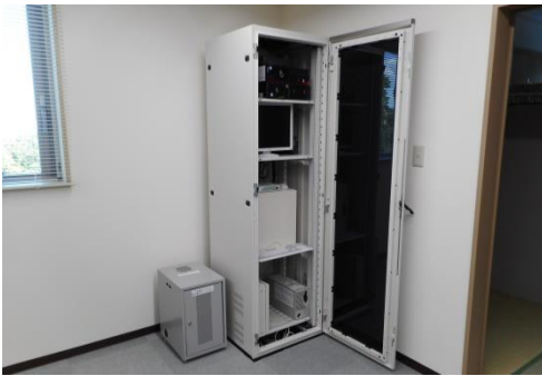
データ収集サーバ (管理棟に配置)
