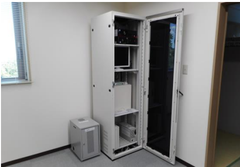
データ収集サーバ (管理棟に配置)
