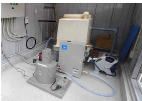
ユニットハウス内の測定装置
