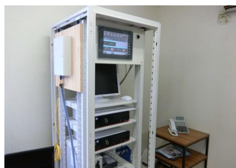
制御盤(業務棟に配置)
