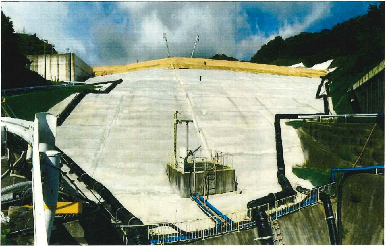
図-1.2 下流中継端子盤付近より埋立地(土堰堤)側
