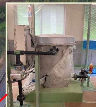
浸出水処理施設 連続測定装置
