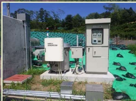
釜場排水連続測定装置
