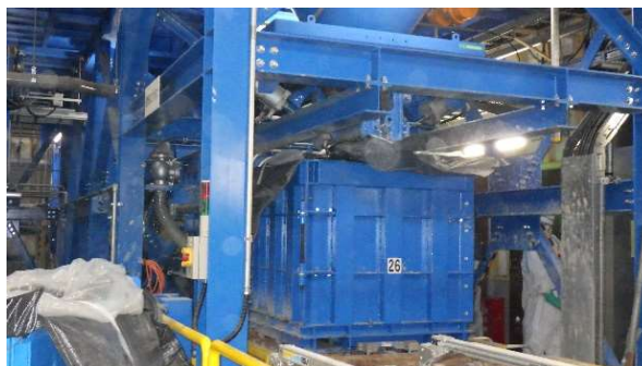
セメント固型化施設
