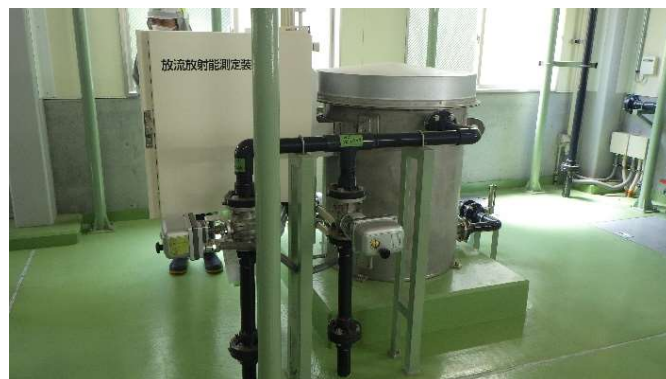
浸出水処理施設
