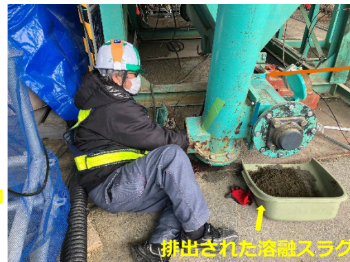
事故発生状況（再現）
