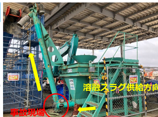
埋立資材製作設備全景
