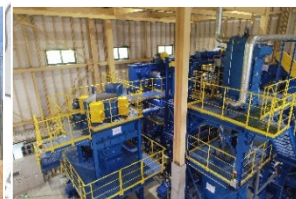
セメント固型化施設
