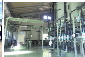
浸出水処理施設
