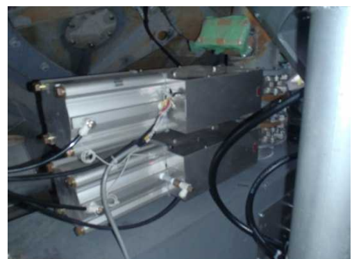
▲ 二重ゲートの開閉検出装置 (設置状況確認時)
