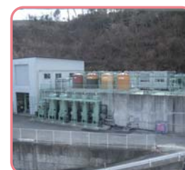
浸出水処理施設
