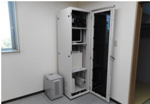
データ収集サーバ (管理棟に配置)
