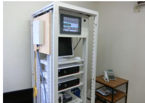
制御盤(業務棟に配置)
