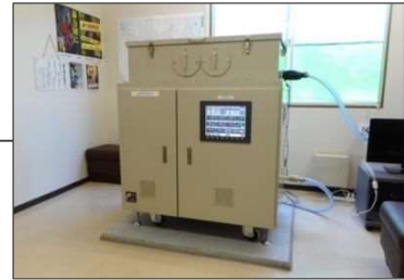
業務棟の測定装置
