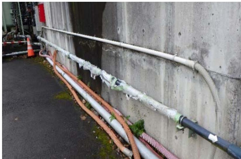
保温材の劣化（令和6年11月21日時点）
