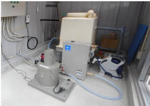
ユニットハウス内の測定装置
