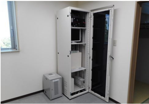
データ収集サーバ (管理棟に配置)
