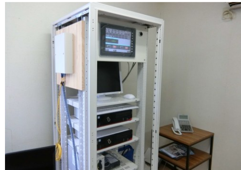
制御盤(業務棟に配置)
