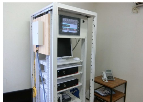
制御盤(業務棟に配置)
