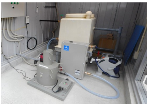
ユニットハウス内の測定装置
