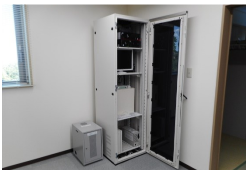
データ収集サーバ (管理棟に配置)
