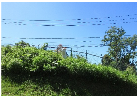
正門付近の測定装置
