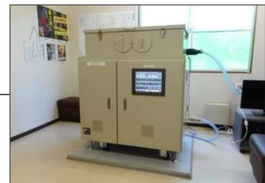
業務棟の測定装置
