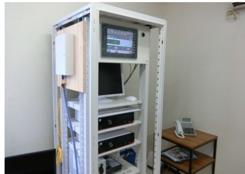
制御盤(業務棟に配置)
