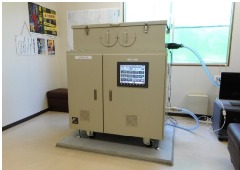
業務棟の測定装置
