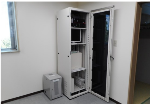
データ収集サーバ (管理棟に配置)
