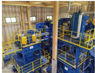
セメント固型化施設（内観）
