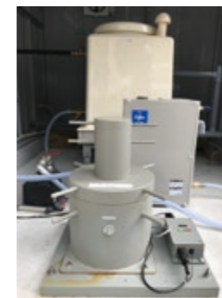
地下水中放射能濃度連続測定装置
