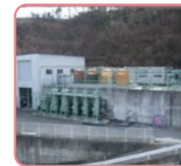
浸出水処理施設
