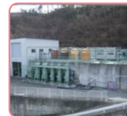
浸出水処理施設
