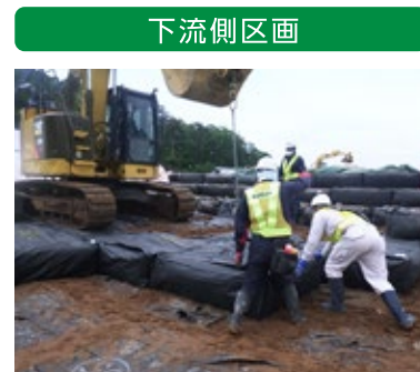
下流側区画: 「セメント固型化しない廃棄物」 の埋立場所
