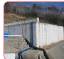
浸出水調整槽
