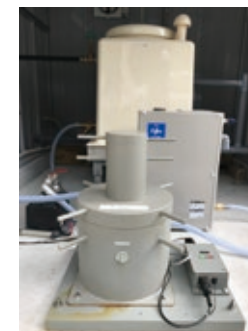
地下水中放射能濃度連続測定装置
