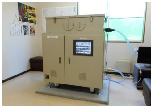
業務棟の測定装置
