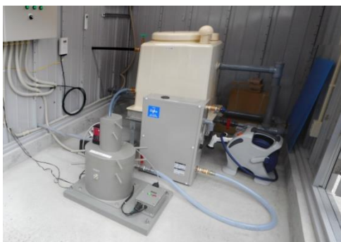
ユニットハウス内の測定装置
