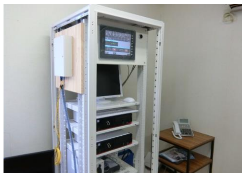
制御盤(業務棟に配置)
