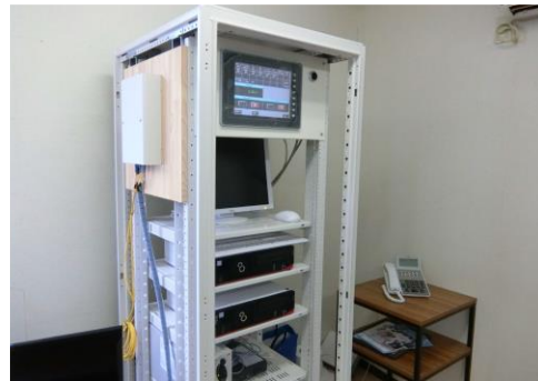
制御盤(業務棟に配置)
