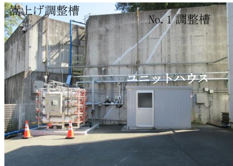
ユニットハウスの状況
