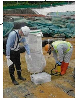
豎管における 埋立ガス採取の状況 (令和2年6月場内下流)
